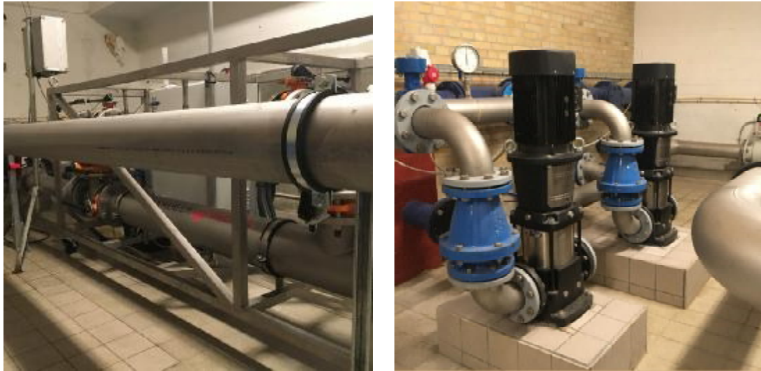
Figur 1-4 Vandbehandling på Dragør Vandværk
