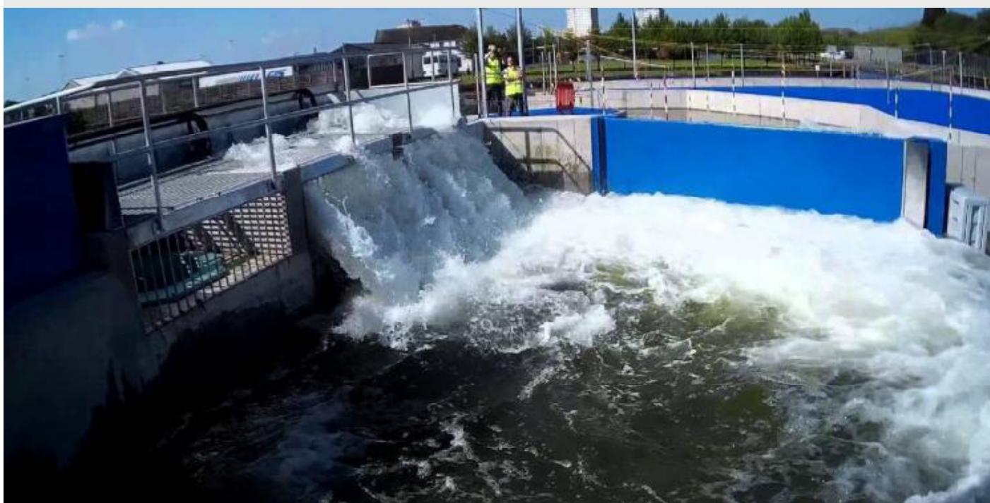
Foto: Pumpestation på anlægget i Glasgow
