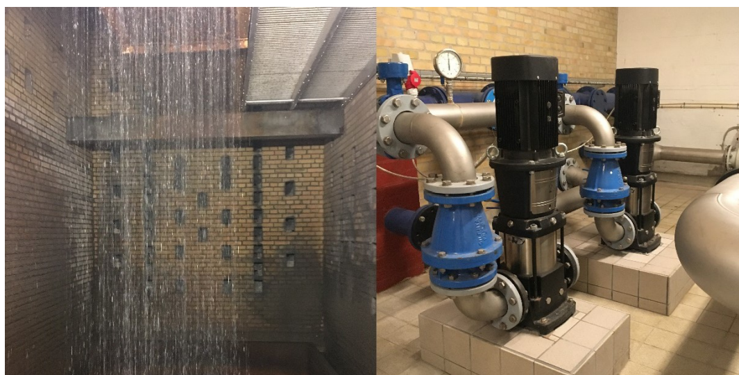
Figur 4-3 Iltningsanlæg og rentvandspumper på Dragør Vandværk
