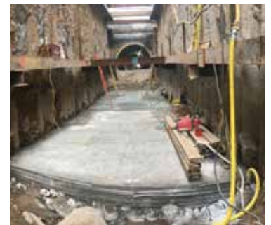
Forsegling af spor pga opstigende grundvand. Foto: MTA Capital Construction Mega Projects, Creative Commons
