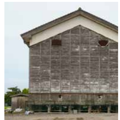
Eksempel på landsætning i Japan hvor ladens søjler er blevet eksponeret pga 1.2 mtr landsætning fra 1966-2004. Shintaku, Shiroishi town, Japan. Foto: Pekachu 2017, WikiCommons
