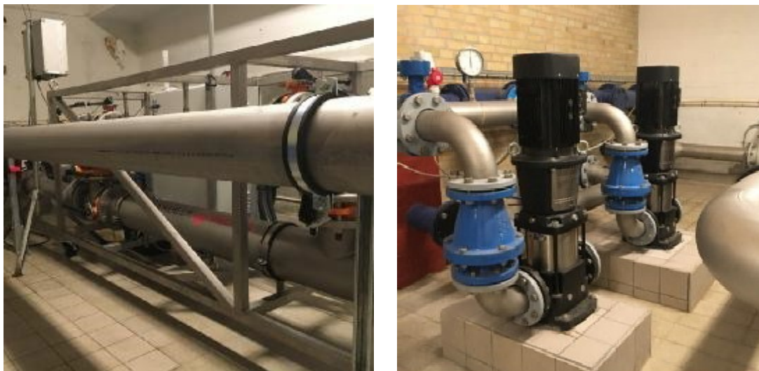
Figur 1-4 Vandbehandling på Dragør Vandværk
